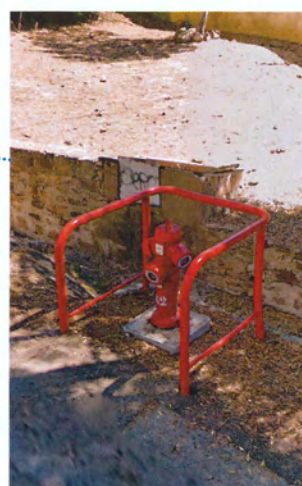
Borne d'incendie PI HRS 62
