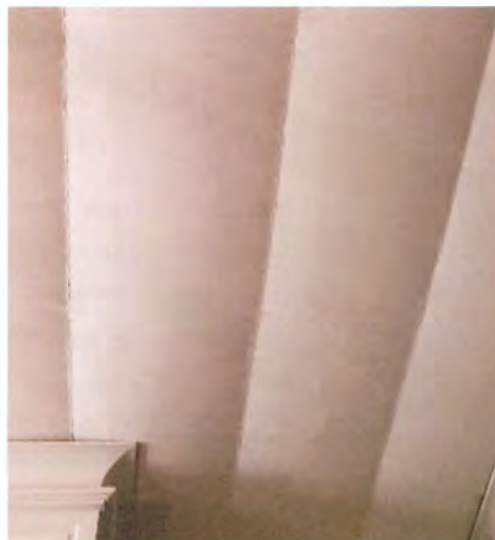
Faux-plafond suspendu acoustique en plâtre type Rockfon
